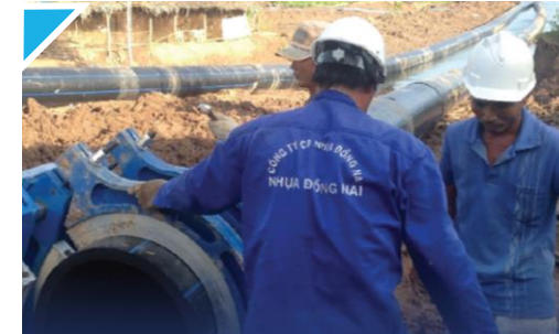
Hệ thống truyền thải nhà máy nước
